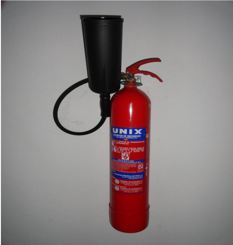
EXTINTOR 5KG CO2
